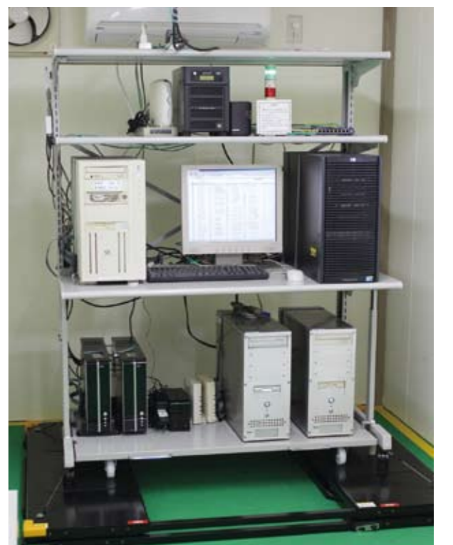
スーパーサポート室の遠隔監視装置
